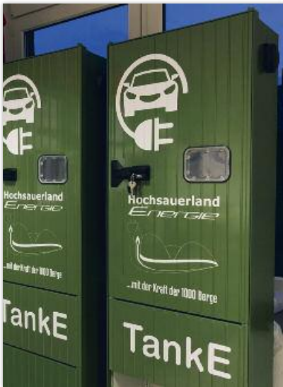
Doppelladesäule der Hochsauerland Energie GmbH
